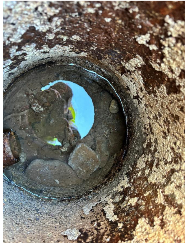
Abb. 4.6: Quellschacht bei Quelle 8.3 (Foto L&H 3.4.2025)
